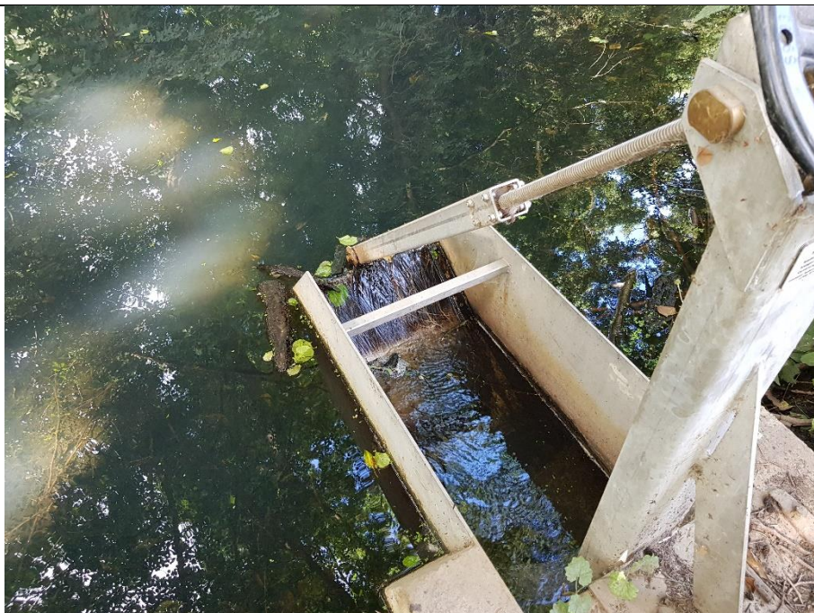
Abschlag aus dem Eichgraben in den Blanken Teich
