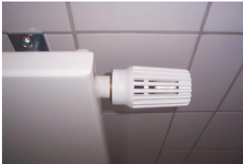
Behördenventil in Klassenraum
