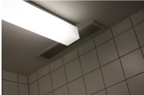
Lüftung in der Umkleide
