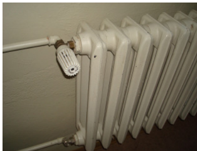
Behördenventile und Heizung
