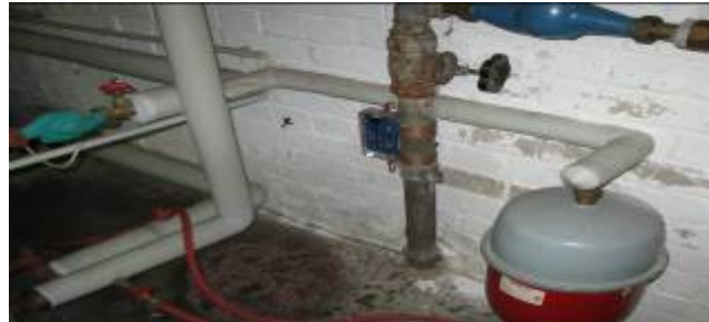
Trinkwasserinstallation in einem Wohngebäude Foto: GA MOL
